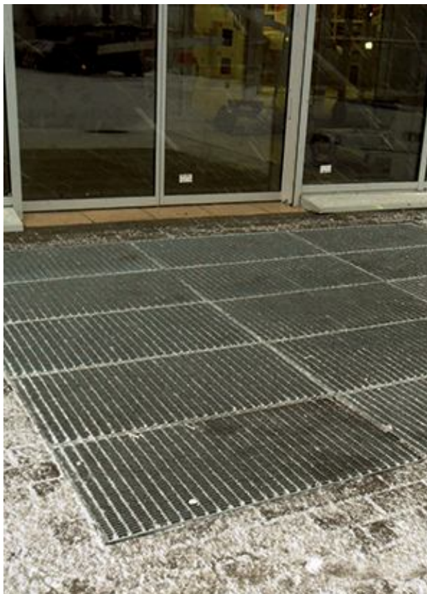
г. Тосно, супермаркет «Лента», придверное грязезащитное покрытие
